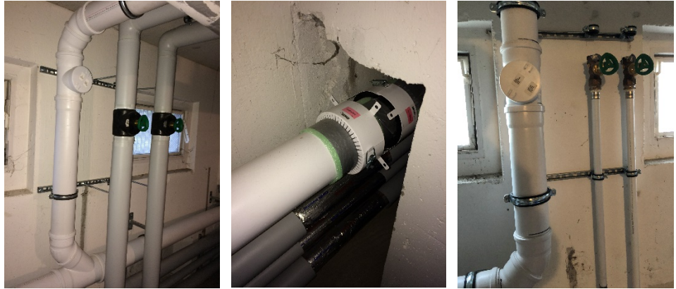
Neu eingebaute Wasser- und Abwasserleitungen mit Brandschutzmanschetten im Kellerschoß
